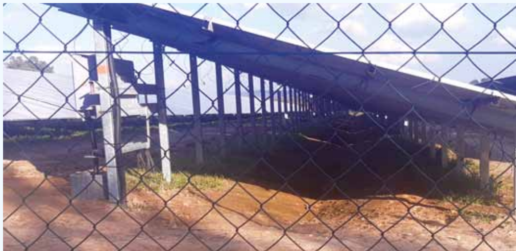
Unter den PV-Modulen zwischen Altenschwand und Meldau wurden Sickergruben angelegt. Aber reichen sie, um Altenschwand bei Starkregen vor Überschwemmungen zu schützen?
